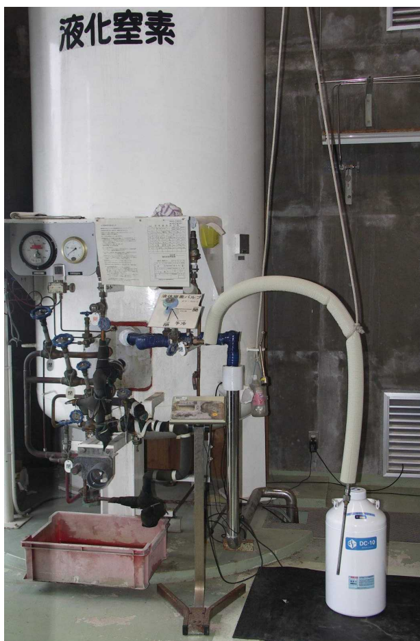
図 5. 液体窒素貯槽用フレキ
